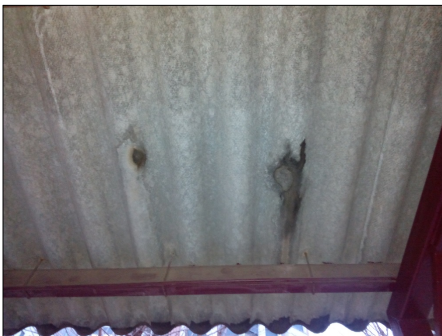
Imatge 4. Detall d'un forat diferent, també amb filtracions d'aigua.
