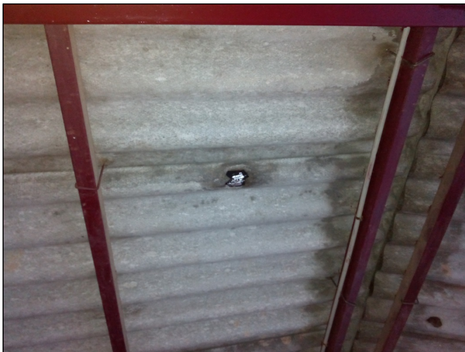
Imatge 3. Detall de forat amb filtracions d'aigua en un dia de pluja.
